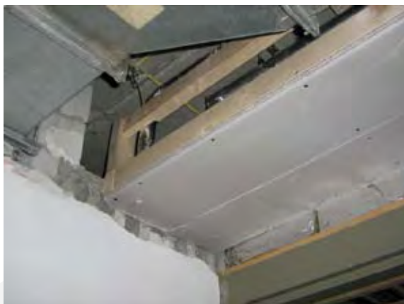
Foto 1: brandwerend plafond → de hoh-afstand van de bevestigingsmiddelen is onvoldoende
