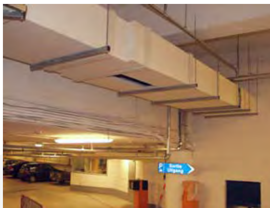
Foto 2: voorbeeld bekleed ventilatiekanaal (promaduct [Promat])
