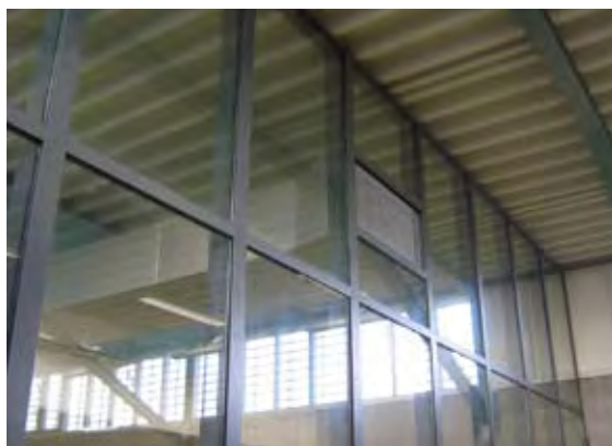
Foto 5: Beëindiging kanaal in stalen pui met glas van ca. 6 m hoog. De brandklep is op ca. 2 m van deze pui voorzien. Het gedeelte van het kanaal tussen de brandklep en de pui is brandwerend geïsoleerd. Ventilatiekanaal zal vervorming van stalen pui niet kunnen volgen bij brand.
