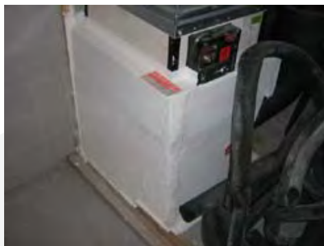
Foto 3: Brandklep op afstand geplaatst. Het gedeelte tussen vloer en het kleppenblad in de brandklep is brandwerend geïsoleerd met steenwolafdichtingsplaten.
