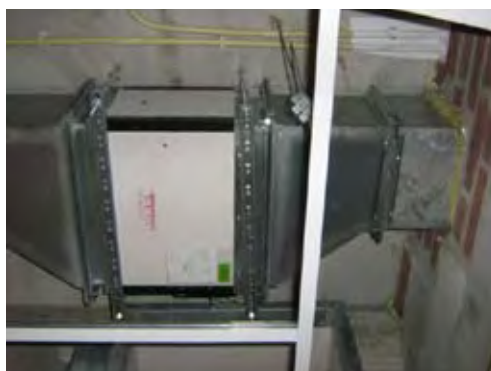
Foto 4: Brandklep op afstand geplaatst. De wand rechts vormt de brandscheiding. Tussen wand en klep is geen brandwerende bekleding voorzien. De klep is bovendien verkeerd om geplaatst. De brandklep is wel correct brandwerend afgehangen.
